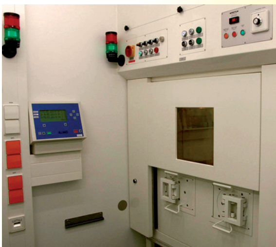
PET Forschungszentrum Rossendorf (ALMO Wandgehäuse, Kabelaustritt unten)
