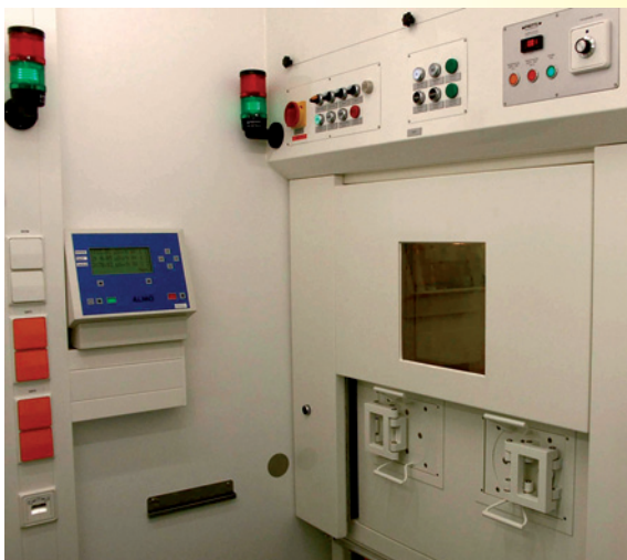
PET Forschungszentrum Rossendorf (ALMO Wandgehäuse, Kabelaustritt unten)
